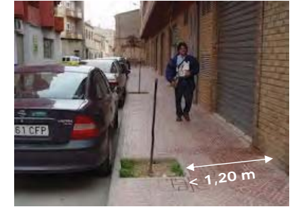
Falta cobertura sobre los alcorques. Distancia a la fachada menor a la mínima para itinerarios accesibles. (1,20 m espacios puntuales)
