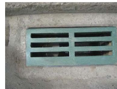
Aperturas de rejas en el sentido de marcha de ruedas, hueco excesivo para las conteras de bastones.
