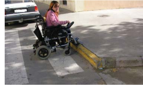
Ausencia de vado. Resalte excesivo
