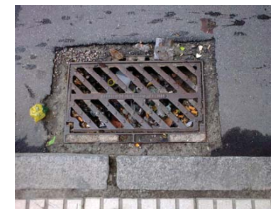
Suciedad y falta de mantenimiento
