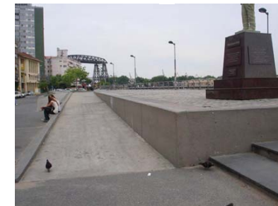
Ausencia de barandilla
